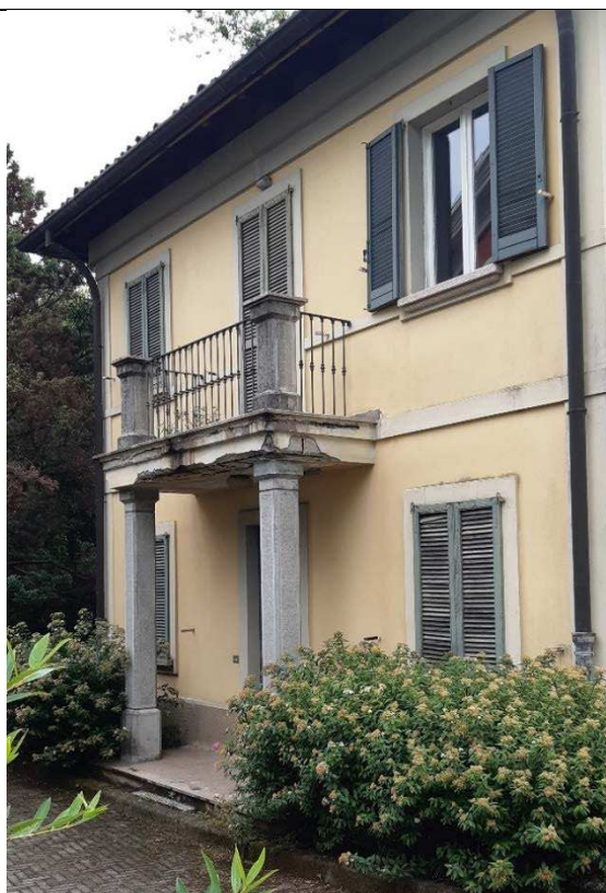
Figura 16 - dettagli stato di manutenzione portico di ingresso
