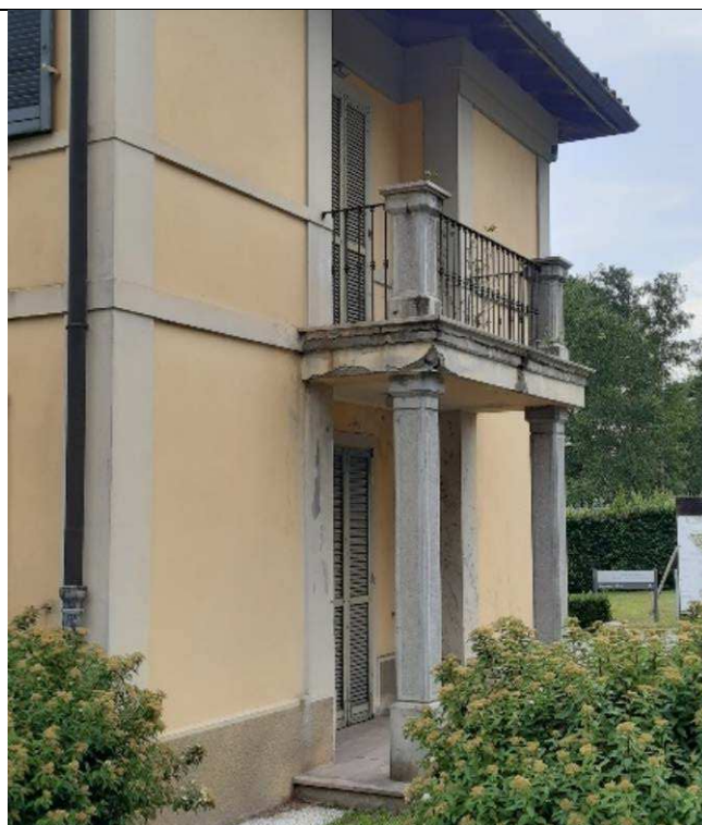
Figura 17 - dettaglio stato manutentivo portico fronte giardino
