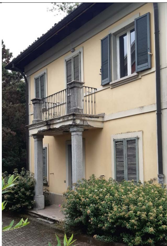
Figura 16 - dettagli stato di manutenzione portico di ingresso
